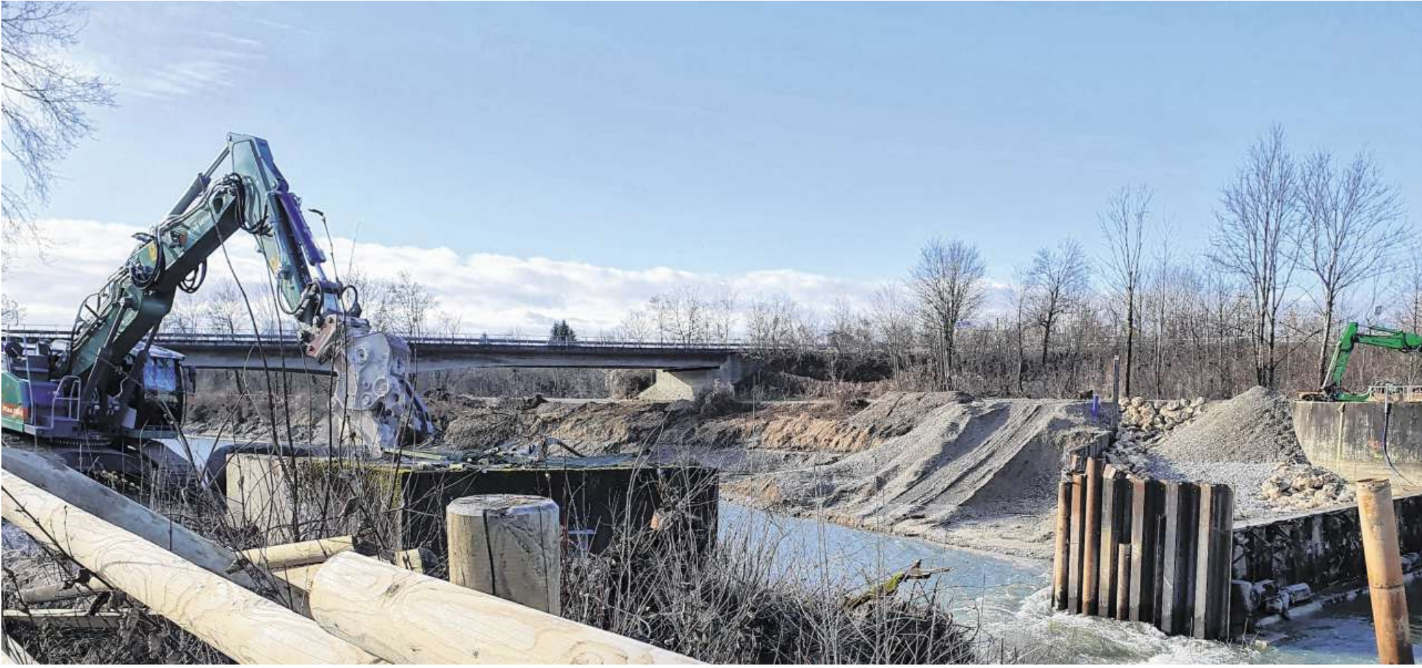
Im Zuge des länderübergreifenden Großprojekts Agile Iller entsteht an der Illerschwele zwischen Egelsee und Heimertingen eine sogenannte Sohlgleite. Mit deren Hilfe soll der Fluss für die Fische durchgängiger werden. Rechts im Bild sind die Spundwände zu sehen, die bei einem Hochwasser im November beschädigt worden sind. Fotos: Johannes Schleckler
